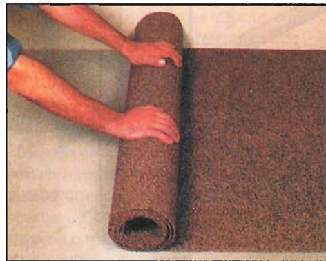
Раскатывают на полу отдельные полосы пробковой подкладки поперек направления укладки будущего напольного покрытия. Грубо обрезают торцы полос.
