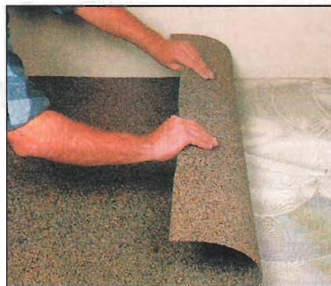
Кладут откинутую часть полосы на проклеенную поверхность пола, прижимают ее к основе и прикатывают валиком из твердого пеноматериала или деревянной скалкой.
